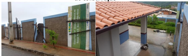
Figura 2 - Unidade Básica de Saúde Bairro Vida Nova – Obra paralisada, cercada com tapumes improvisados, e em más condições de conservação
